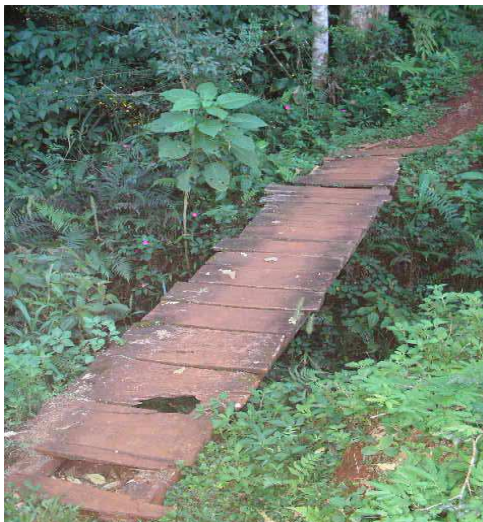
Figura 2 - Condições precárias da ponte que dá acesso a cachoeira
