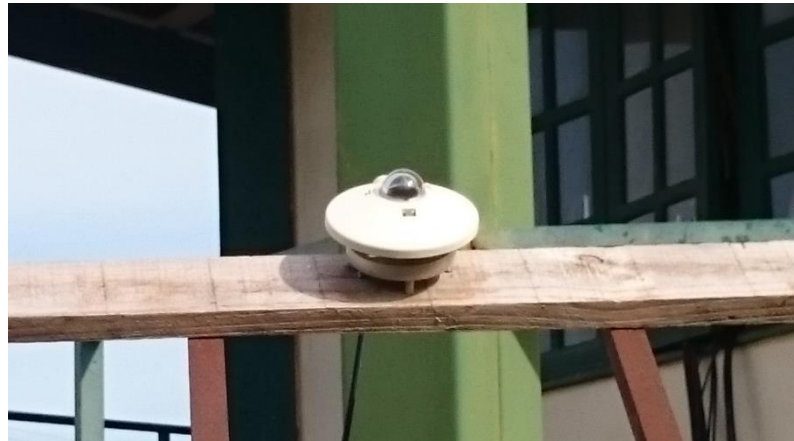
Figura 17. Piranômetro CMP3 instalado no plano do painel.
