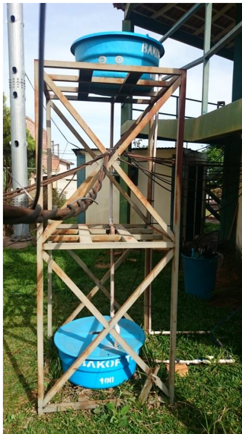
Figura 16. Estrutura e curso hídrico do sistema de bombeamento.
