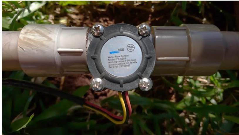
Figura 19. Sensor de fluxo de água instalado.
