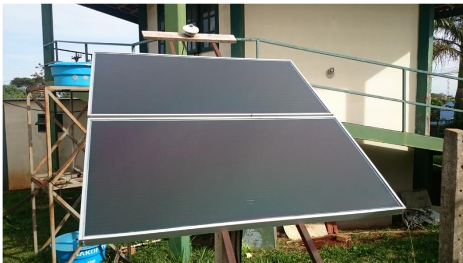
Figura 13. Painel fotovoltaico de silício amorfo instalado.
