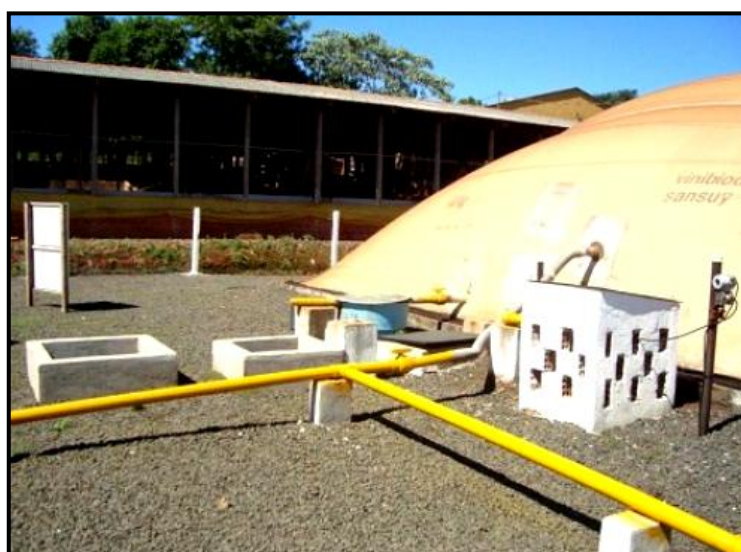
Figura 59 - Tubulação de equalização e saída de biogás dos biodigestores 1 e 2.
