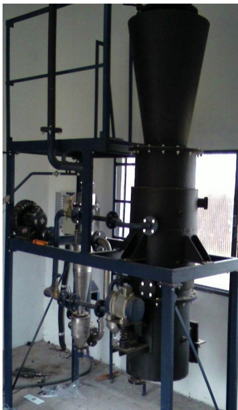
Figura 7- Unidade de gaseificação instalada no laboratório de Bioenergia
