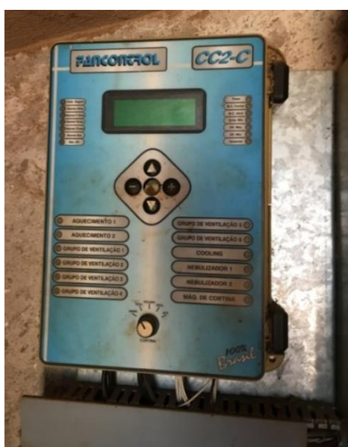
Figura 22: Sistema de controle do aviário AV1 – FanControl CC2-C.
