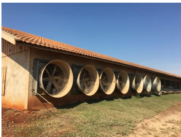
Figura 27: Sistema de ventilação – exaustores do aviário AV1.
