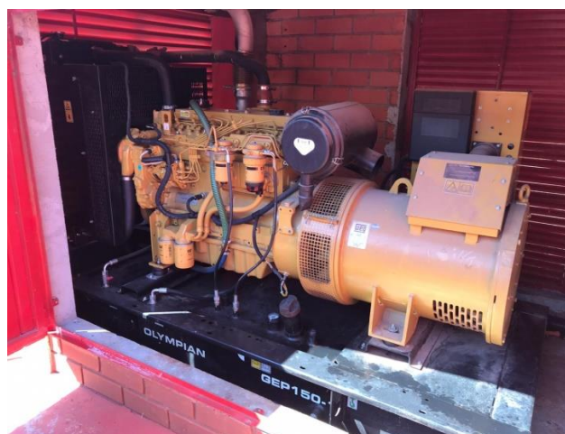
Figura 33: Sistema de gerador – BR Geradores Olympian GEP-15- 1006TAG dos aviários AV1 e AV2.
