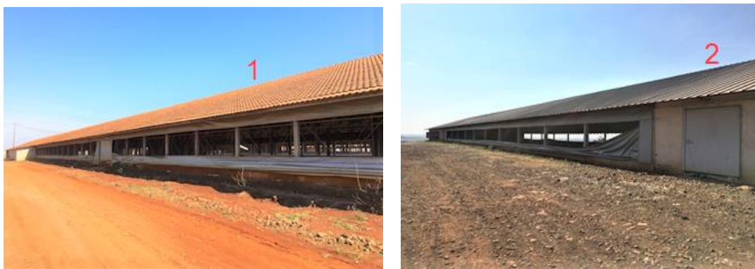
Figura 18: Telha cerâmica de barro do aviário AV1 (1). Telha de aluzinco trapezoidal TRP35 do aviário AV2 (2).
