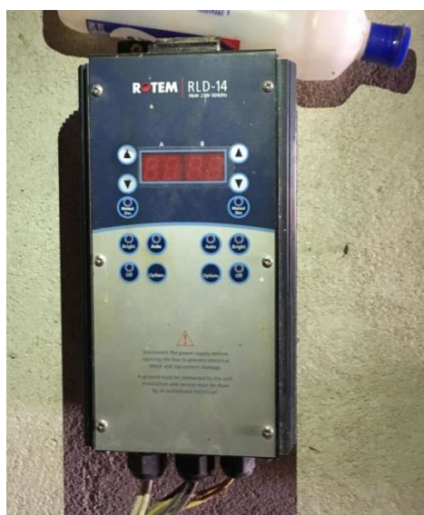
Figura 39: Sistema de iluminação – dimmer Rotem RLD-14.
