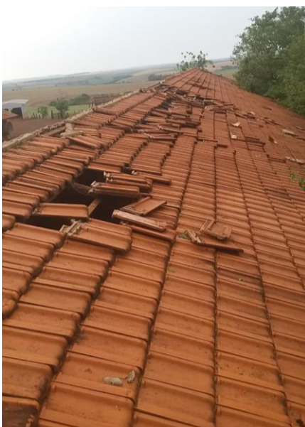
Figura 45: Cobertura do aviário AV1 após temporal.
